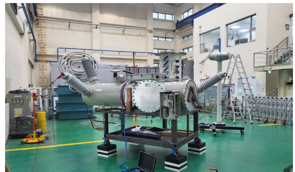
그림 3. 고속도 접지개폐기 뇌 임펄스 시험 전경 Fig. 3. Experimental setup for the lightning impulse withstand test of the HSES
