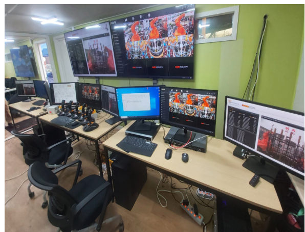
그림 11. 원격 컨트롤룸 내부 2 Fig. 11. Inside the remote control room 2
