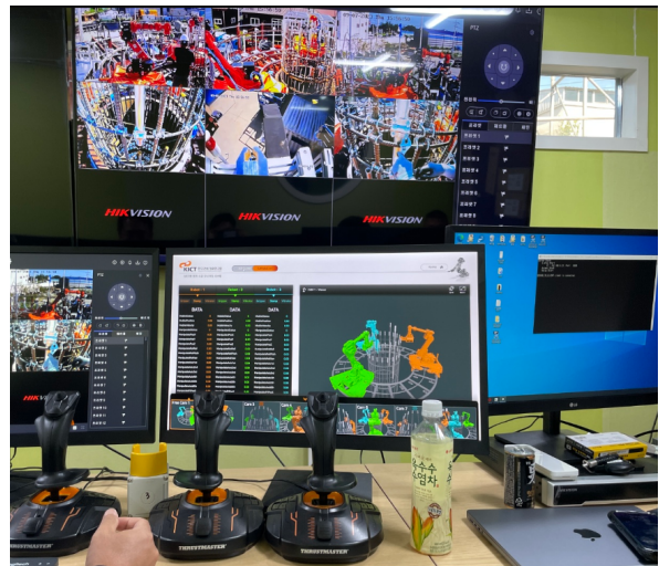
그림 10. 원격 컨트롤룸 내부 1 Fig. 10. Inside the remote control room 1
