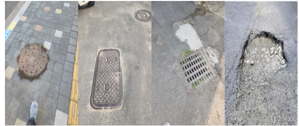
그림 4. 원, 사각형 맨홀, 빗물받이, 포트홀 영상 Fig. 4. Images of the circle, rectangle manhole, rain gutter, and pothole
