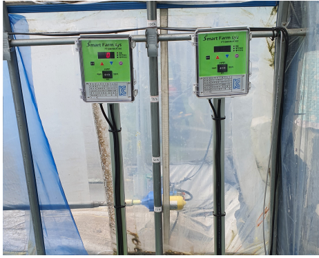
그림 10. 비닐하우스에 설치된 스마트 구동기 노드와 Fig. 10. Smart driver node and switchgear installed in green house
