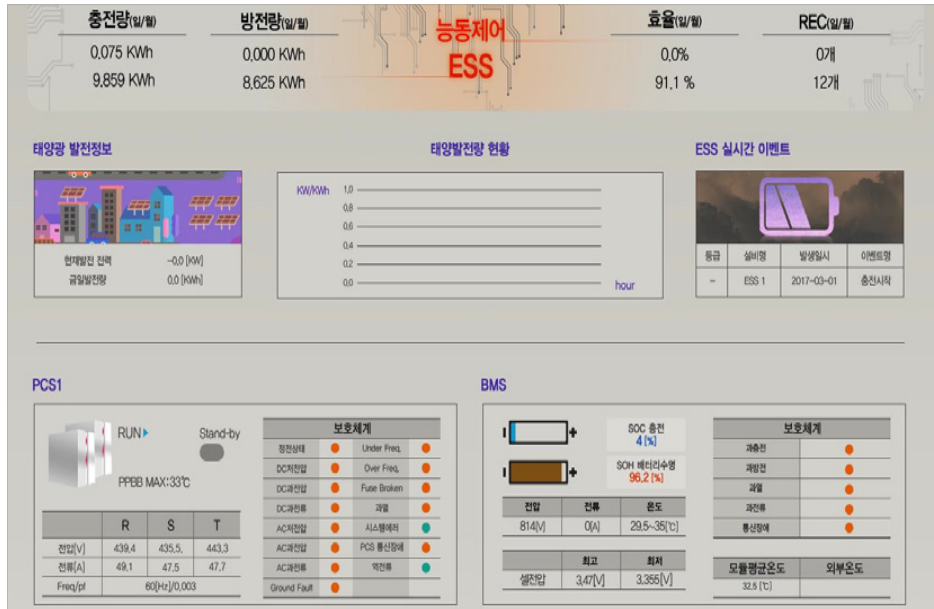
그림 4. ESS 상태정보 모니터링 Fig. 4. Monitoring of state information for ESS
