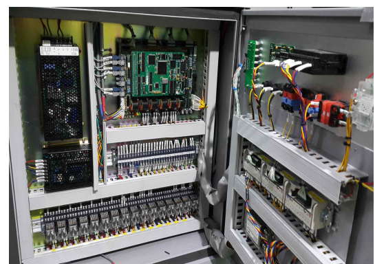
그림 11. 용해로 제어판넬 내부 Fig. 11. Inside of melting furnace control panel
